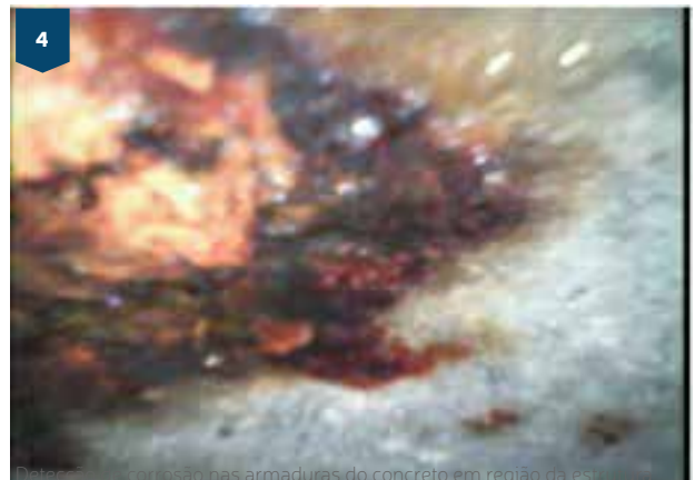
Detalhe de corrosão nas armaduras do concreto em região da estaca sem acesso para visualização. A câmera foi inserida através de um orifício e assim possibilitou-se a identificação da manifestação patológica que não seria identificada somente com a realização de inspeção visual.
