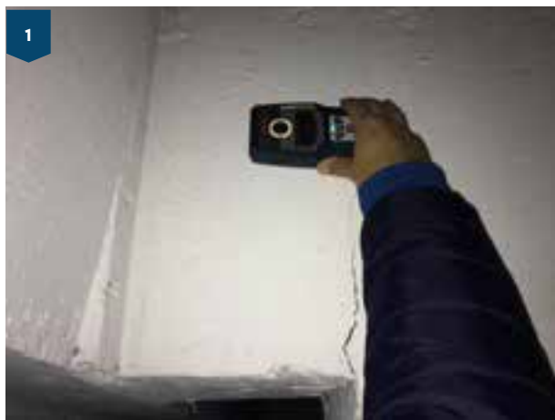
Na foto a utilização da pacometria foi utilizada numa viga de concreto armado e atestou a ausência e variações de distanciamento de es armaduras transversais ao qual provavelmente estão contribuindo para a ocorrência da fissura na viga
