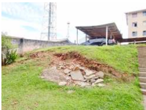
Foto 11 – Erosão no solo, com risco de desmoronamento.
