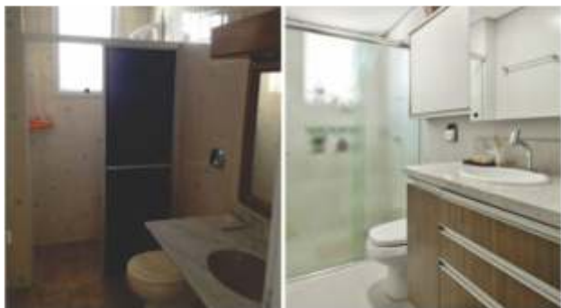
Fotos 1 e 2 - Mesmo banheiro, com estado de conservação distintos. Fonte: https://casaconstrucao.org/projetos/reforma-de-apartamento/
