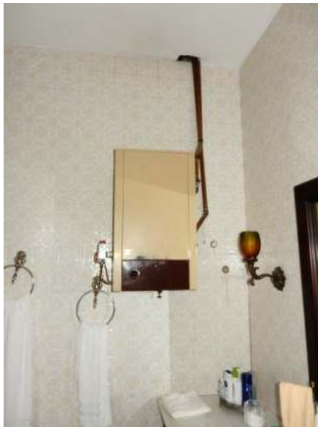
Foto 13 – Residência com aquecedor dentro de banheiro, com risco elevado aos usuários.
