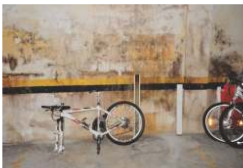
Foto 12 – Detalhe de infiltração em edifício residencial novo.
