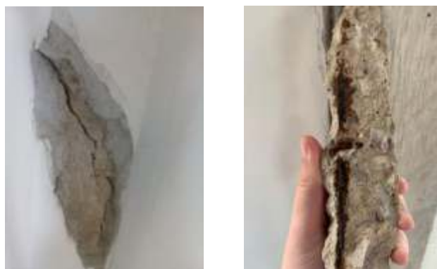
FOTO 05 – Extração de um ponto com corrosão de armadura por cloreto
