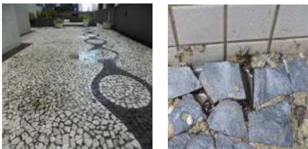
FOTO 06 – Acúmulo de água em pavimento
