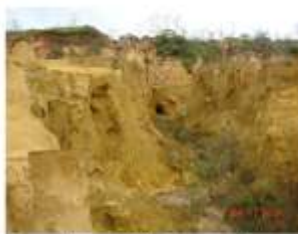
Figura 23: erosão típica causada por piping no terreno abaixo da fundação original do vertedouro.
