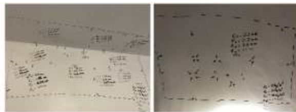
Figura 13 — Painos de monitoramento de fissuras (paino 1 - esquerda: centro da viga lateral da suíte; paino 2 - direita: centro da laje da suíte) Fonte: Autor, 2017.
