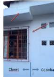
Figura 6 — Trincas na parede externa do closet/cozinha Fonte: Autor, 2017.
