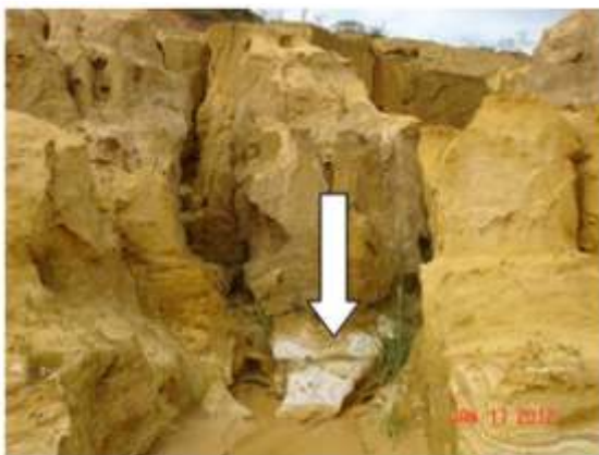
Figura 21: Arenito branco friável no qual deveriam ter sido fundadas as estruturas do vertedouro
