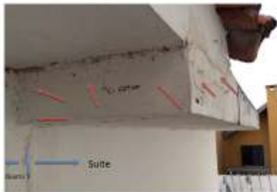
Figura 8 — Trincas presente na cobertura externa da suíte/quarto 1 Fonte: Autor, 2017.
