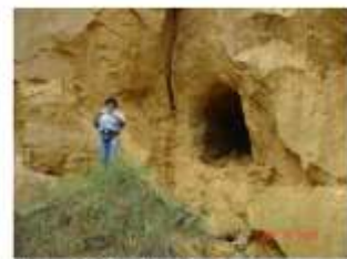
Figura 24: Detalhe do piping erosivo com formação de galeria de dimensão métrica com profundidade de 5 m.
